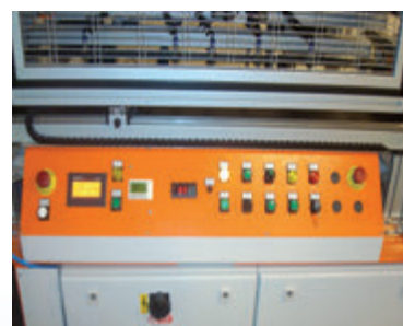
Particolare quadro comandi
